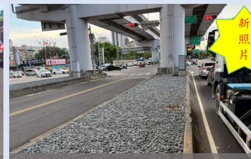
改善後 潭美國小周邊-分隔島灌木阻擋路口視線 移除後減少視線遮擋
