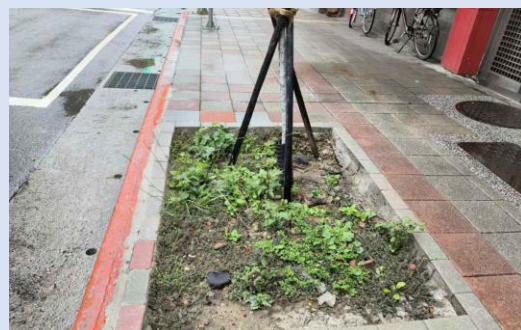
改善前 松山區三民里三民路133號前-土壤流失造成路面高低差
