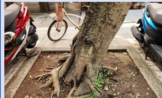
改善前 北安路817-1號前·植穴內與路面高低差
