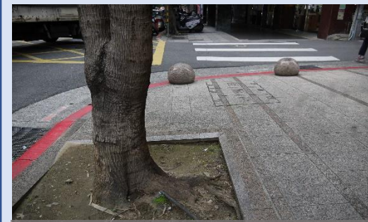
改善前 林森北路587號前·補土後路面減少高低差
